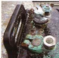
腐食したバッテリーターミナルの配線部
