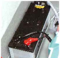
新品のバッテリーターミナルの配線部
